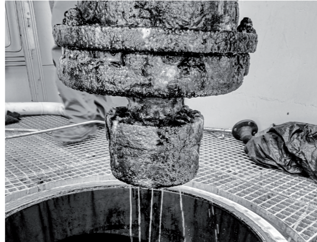
MPCTAN bis zuletzt funktionierende Pumpe, nur Leistungsminderung durch Verschmutzung
